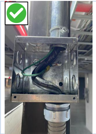
Imagen 47: Buenas prácticas en tuberías metálicas flexibles.
