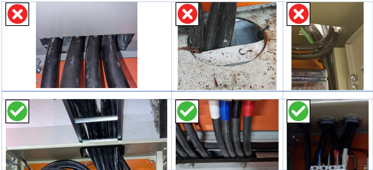
Imagen 14: Buenas y malas prácticas en acoplamiento de canalizaciones o ingreso de conductores a tableros.
