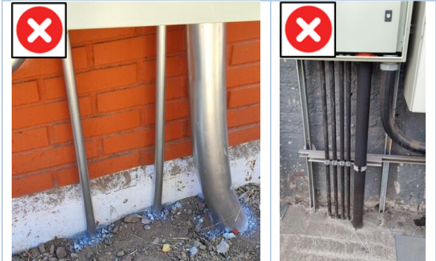
Imagen 42: Exposición de tuberías no metálicas a radiación solar.
