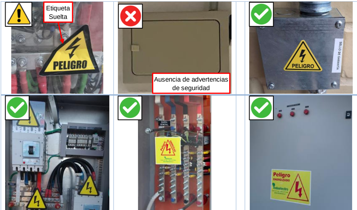
Imagen 21: Buenas y malas prácticas. Señalización de peligro o riesgo eléctrico.
