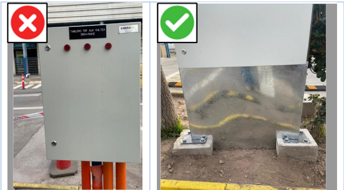
Imagen 41: Exposición de tuberías no metálicas a radiación solar.
