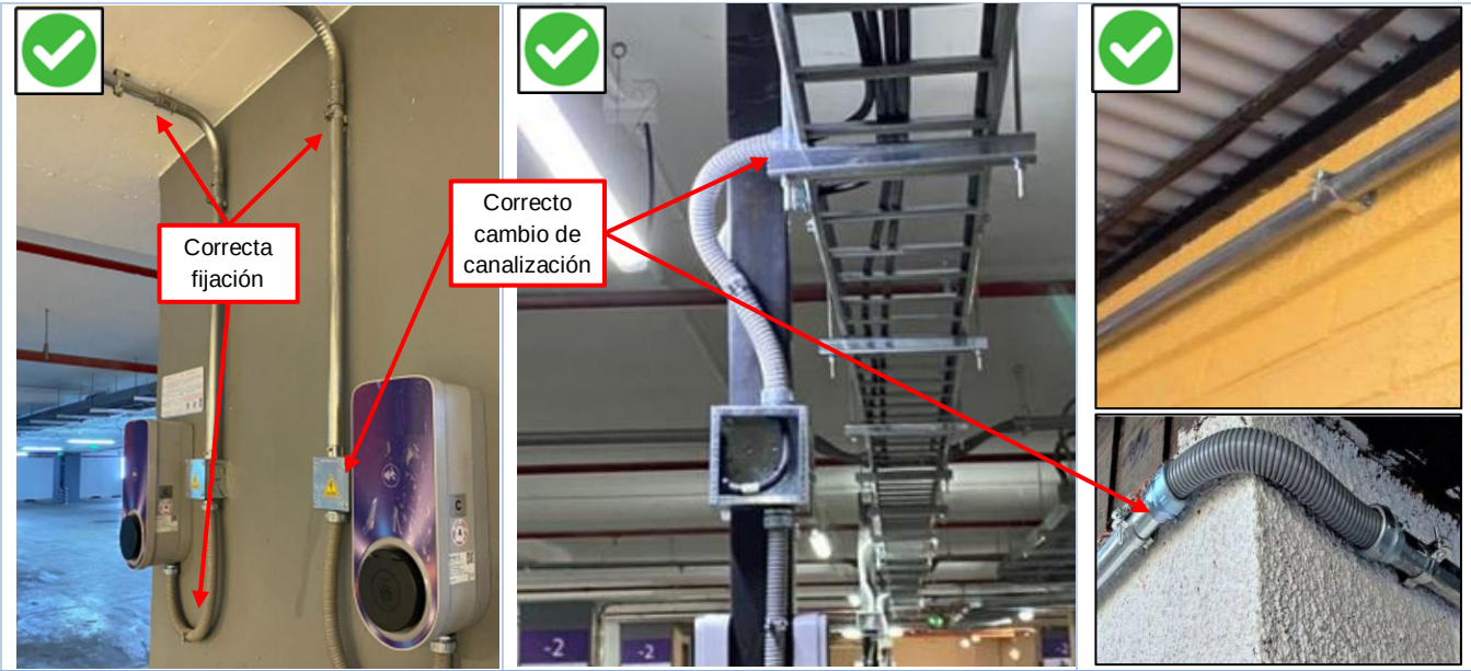
Imagen 45: Buenas prácticas en canalizaciones.
