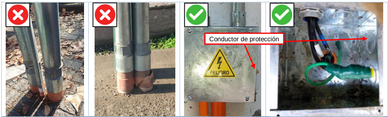
Imagen 43: Mezcla de canalizaciones de ductos metálicos con ductos no metálicos.
