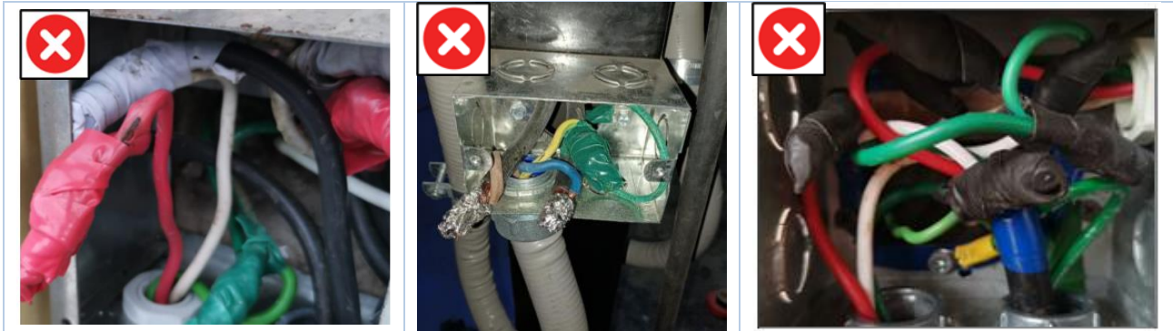
Imagen 38: Malas prácticas uniones de conductores.
