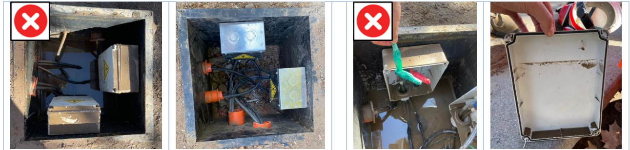
Imagen 39: Malas prácticas uniones de conductores dentro de cámara.
