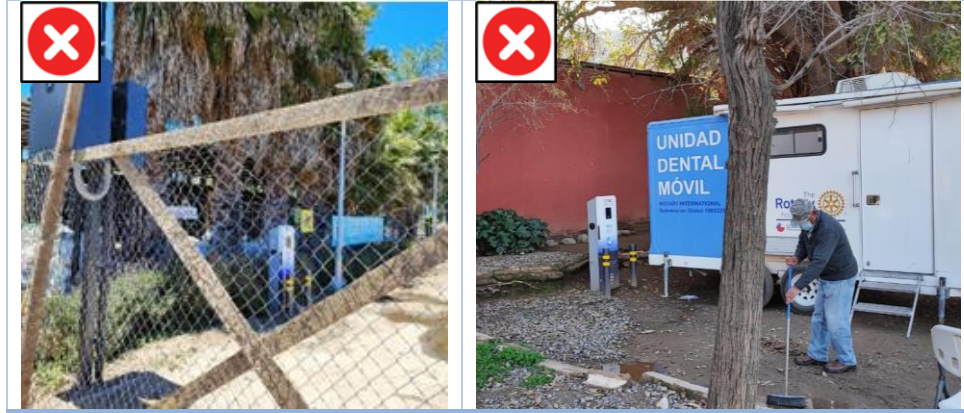
Imagen 9: SAVE instalados en zonas inaccesibles.
